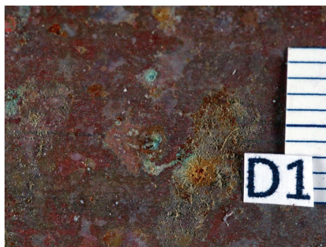
Rys. 3. Ten sam odcinek rurociągu co na rys. 2 przy powiększeniu 20×. Widoczne produkty korozji (wykwity) na powierzchni materiału
